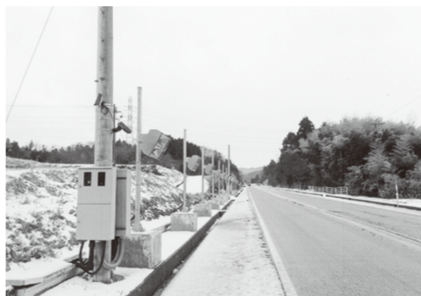
▲遠赤外線融雪装置 国道8号 津幡町
